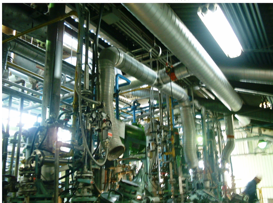
写真－2：局所排気ダクト（各リアクターの局所排気ダクト）
