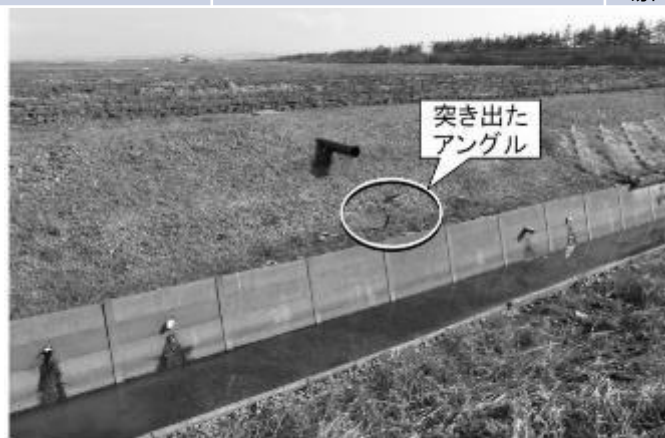
図3 刈刃にあたったアングルの位置 (アングルは以前、排水樋の支柱だったが、現在は埋ビパイプに換えたので不要になっている)
