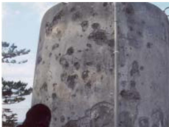
2003年4月16日 国立療養所沖縄愛楽園 機銃掃射を受けて蜂の巣状になった給水塔
