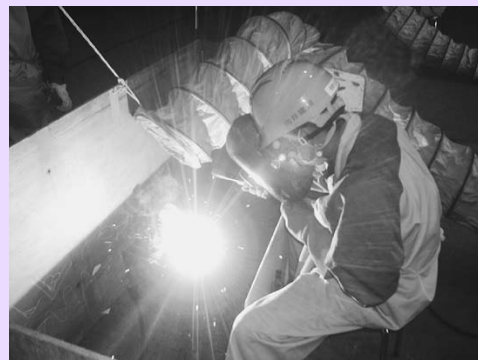
アーク溶接訓練
