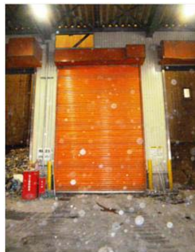
ピット前シャッター
