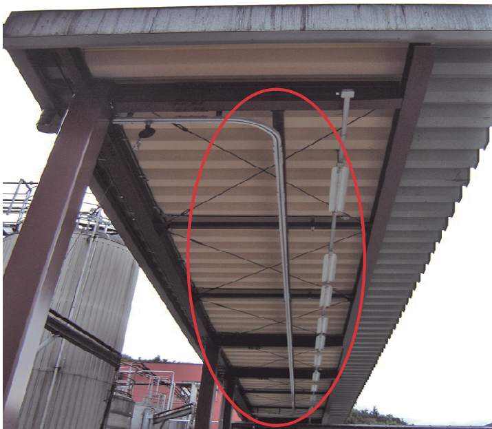
図 4-32 建屋天井に設置したレール。運転手が安全帯を着けても容易に移動できるようにしている。
