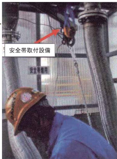
図 4-30 タンクローリー上部の建屋内に設置された安全带取付設備
