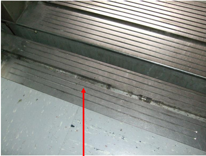
目視：扉溝の土砂の堆積が目立つ 、扉溝の剥離汚水の付着
