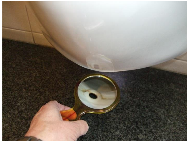
目視：小便器下部の裏面に汚れ
