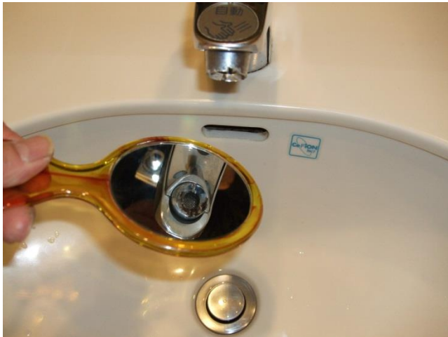
目視：蛇口の裏面に汚れ
