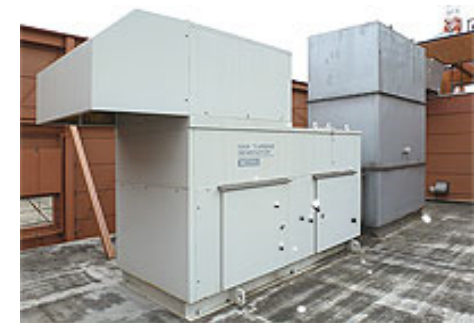
（非常用自家発電装置）
