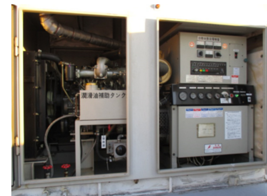
<自家発電設備>
