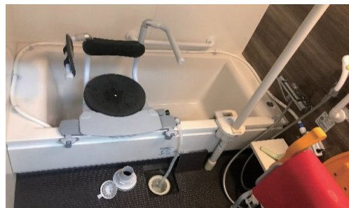
機器の設置状況
